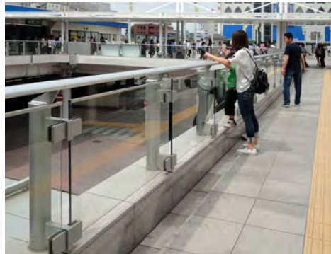
コンクリート高欄から軽量で透過性のあるガラス高欄に改修
