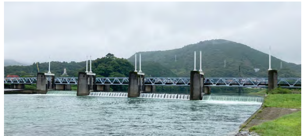
完成から20年近く経過した可動堰と管理橋、年数を経てコンクリート製堰柱は苔や微で黒くなり、現地の風景に溶け込んでいるように見える
