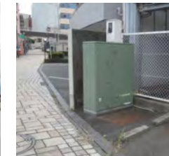
電線地中化のトランスは民地側に設置
